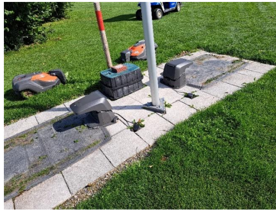
Abbildung 4: Ladestation für zwei Rasenmäroboter (Bild: ILOS)
